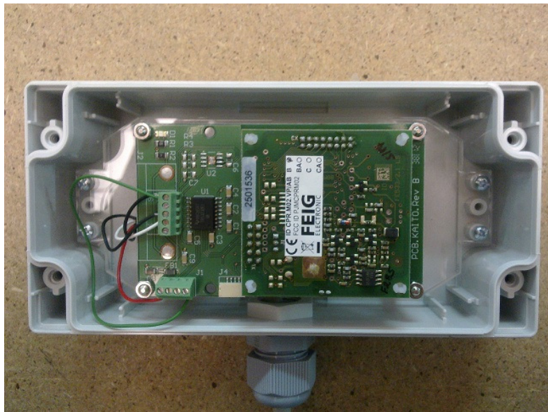
Fig. 12 - Lector abierto con cables conectados en J1 y J2
